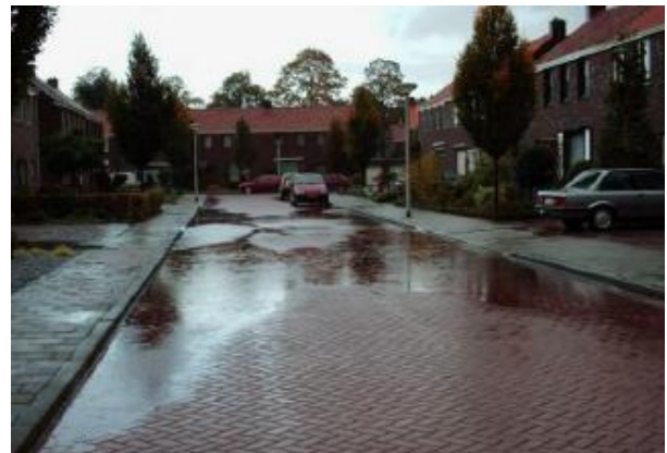
Figuur 4: Waterhinder op een infiltrerende verharding
