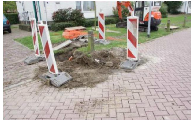
Figuur 8: Vervuiling van de verharding door graafwerkzaamheden
