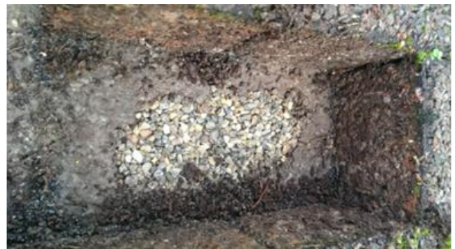
Figuur 22: Verbrijzeld voegmateriaal
