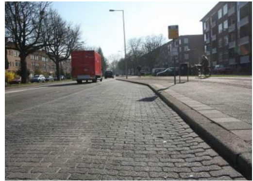
Figuur 14: Spoorvorming in de busroute
